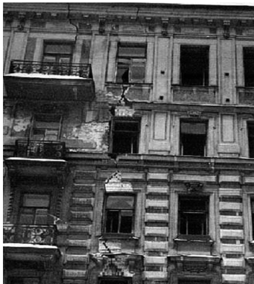
Рис. 9.19. Аварийные деформации д. 8 по Мичуринской ул.
