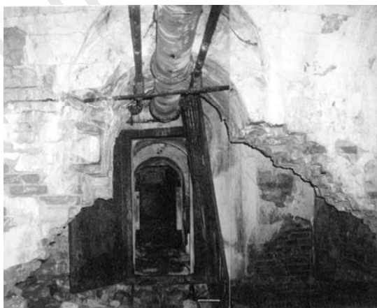
Рис. 5.11. Разрушение поперечных стен
