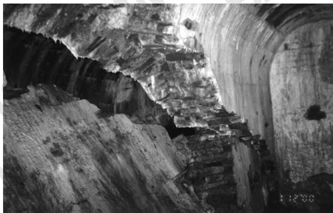
Рис. 5.12. Обрушение поперечной стены
