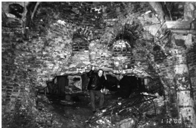
Рис. 5.13. Обрушение подпорной стены
