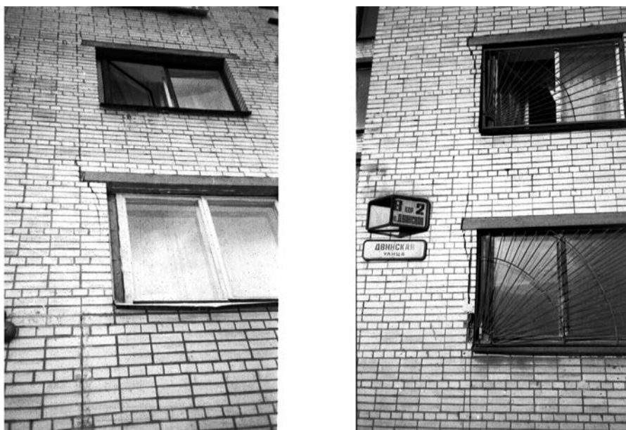
Рис. 5.31. Трещины в симметричном блоке здания по ул. Двинской 8, кор. 3 и в соседнем здании (ул. Двинская 8, кор. 2)
