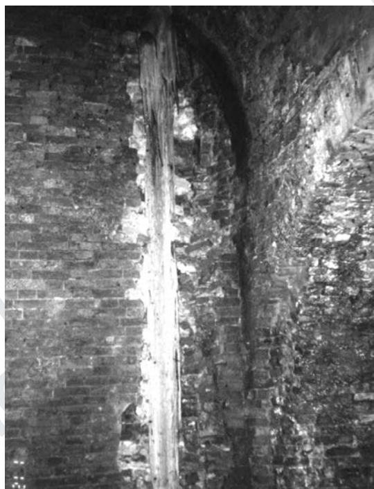
Рис. 5.9. Разрушение ливнестока в лоджии
