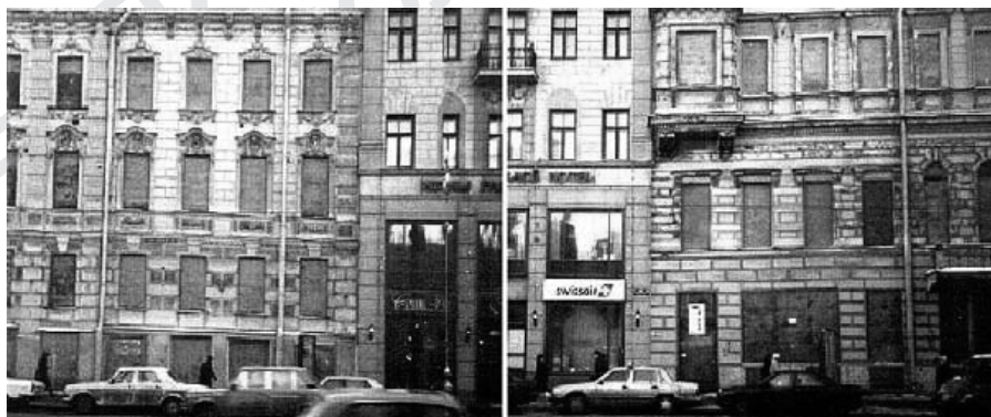
Рис. 9.18. Аварийно деформированные дома №55 и 59 по Невскому пр.
