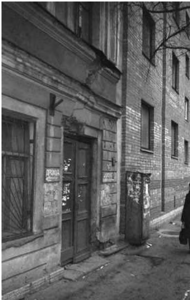
Рис. 7.7. Развитие трещин в кирпичных стенах примыкающего исторического здания
