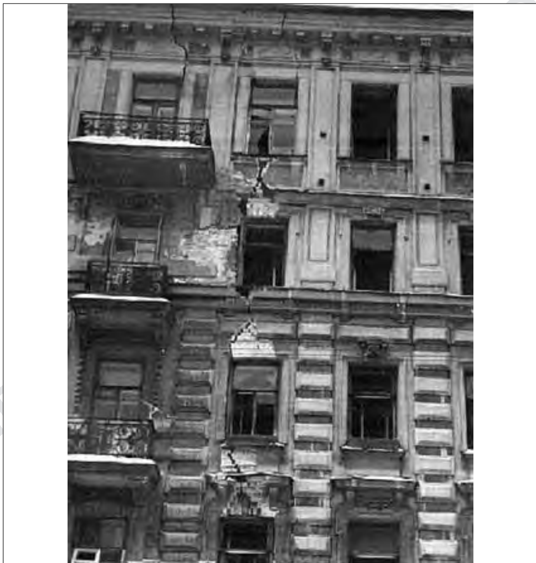
Рис. 1.7. Аварийные деформации дома № 8 по Мичуринской улице
